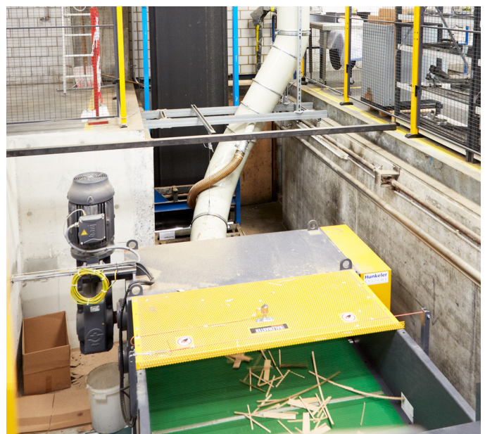
Für die Entsorgung der Kartonabfälle mehrerer Weiterverarbeitungsmaschinen ist ein Hochleistungs-Schredder, beschickt über ein Transportband, in das System integriert.
