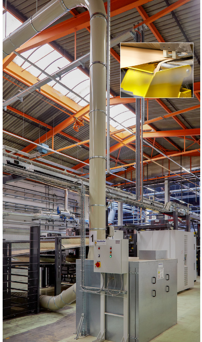
Die Randstreifenabsaugung (kleines Bild) und ein Hackventilator stellen den Betrieb der Wellpappenanlage sicher.
