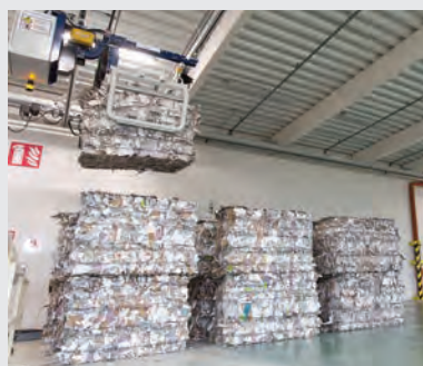
Les installations de grue garantissent une exploitation automatique
