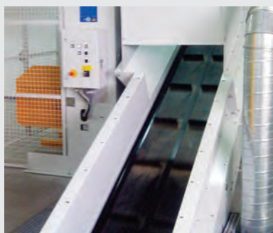
Solutions avec des convoyeurs pour des déchets encombrants
