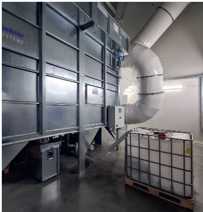
Die Anlage der Hunkeler Systeme AG arbeitet nach dem bewährten Unterdruckprinzip, wobei der Ventilator ganz am Ende des Systems angeordnet ist.
